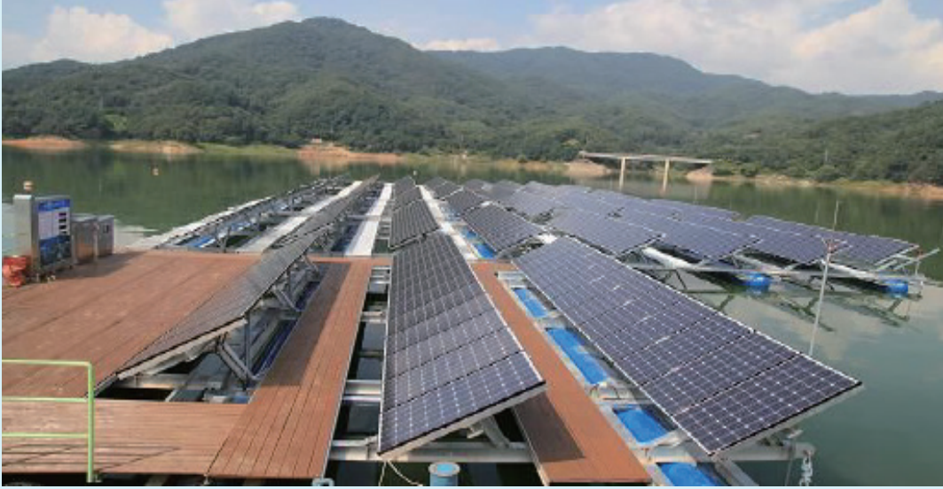
[그림 12. 100kW급 합천댐 수상태양광 실증플랜트]
