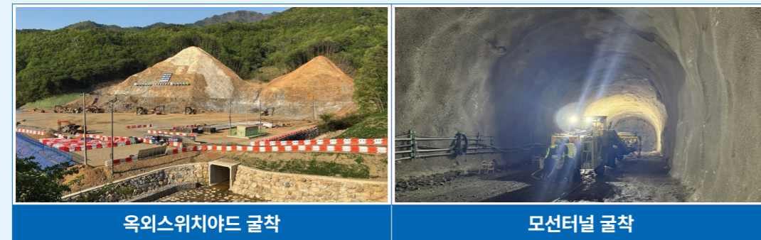
[그림 11] 영동양수 옥외스위치야드 및 모스터널 시공사진
