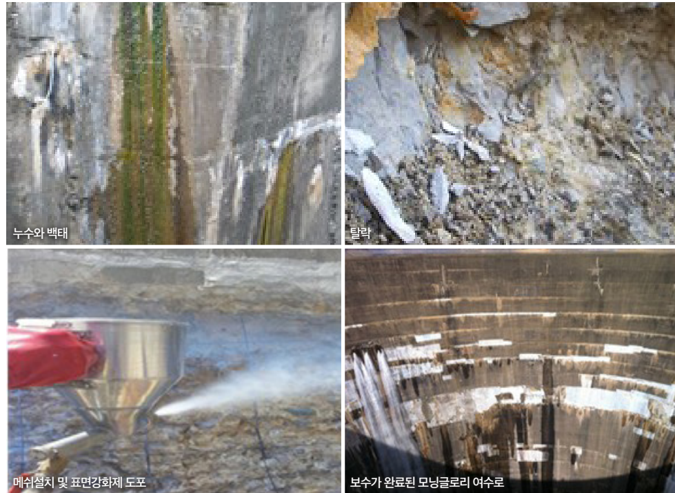
그림 33. 모닝글로리 타입 콘크리트 여수로의 노후화 사례
