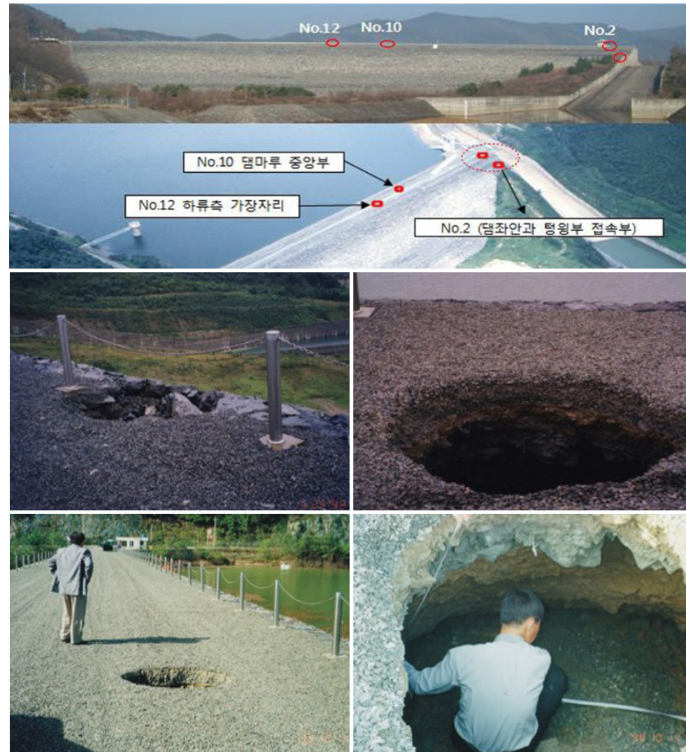
그림 30. 준공 후 4년이 경과한 필 댐의 노후화로 인한 사고사례
