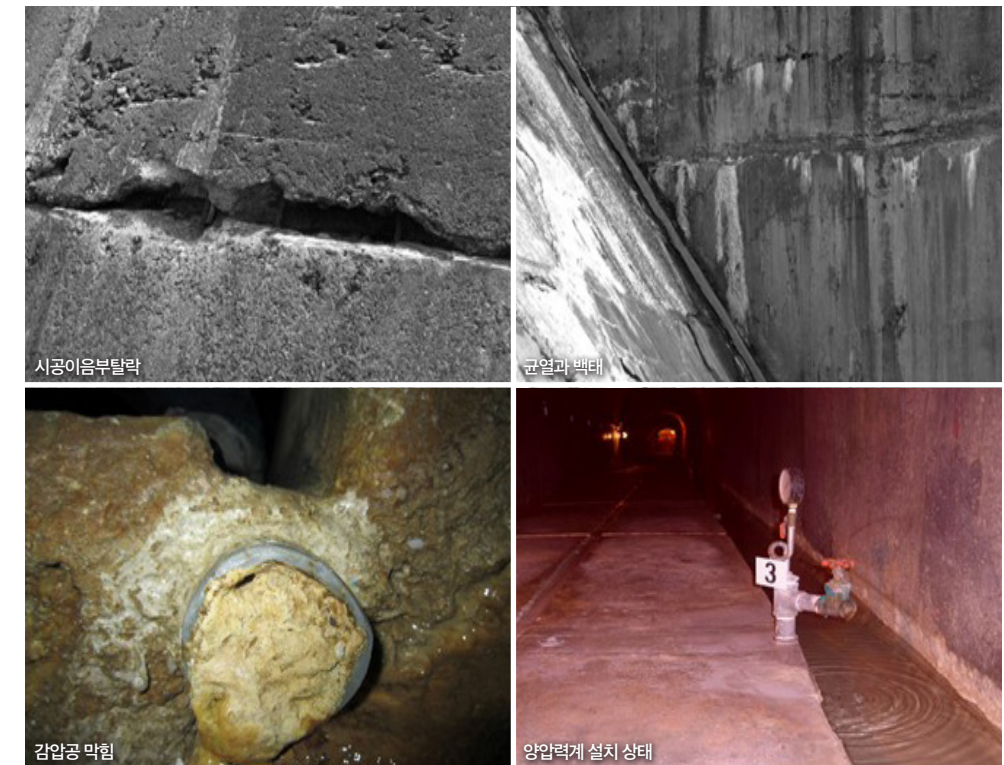
그림 32. 콘크리트댐의 노후화 사례
