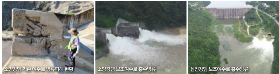
그림 14. '20년 홍수 시 기존 여수로 방류손상 및 보조여수로 활용현황
