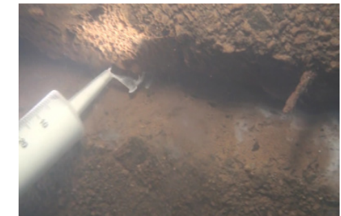
그림 31. 콘크리트댐 상류 시공이음부를 통한 누수경로 발생 확인
