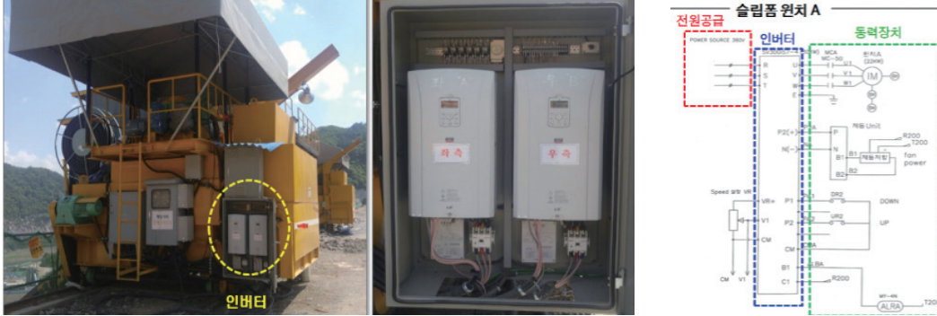
〈그림 24〉 인버터 설치 전경(좌) 및 전력공급 계통도(우)
